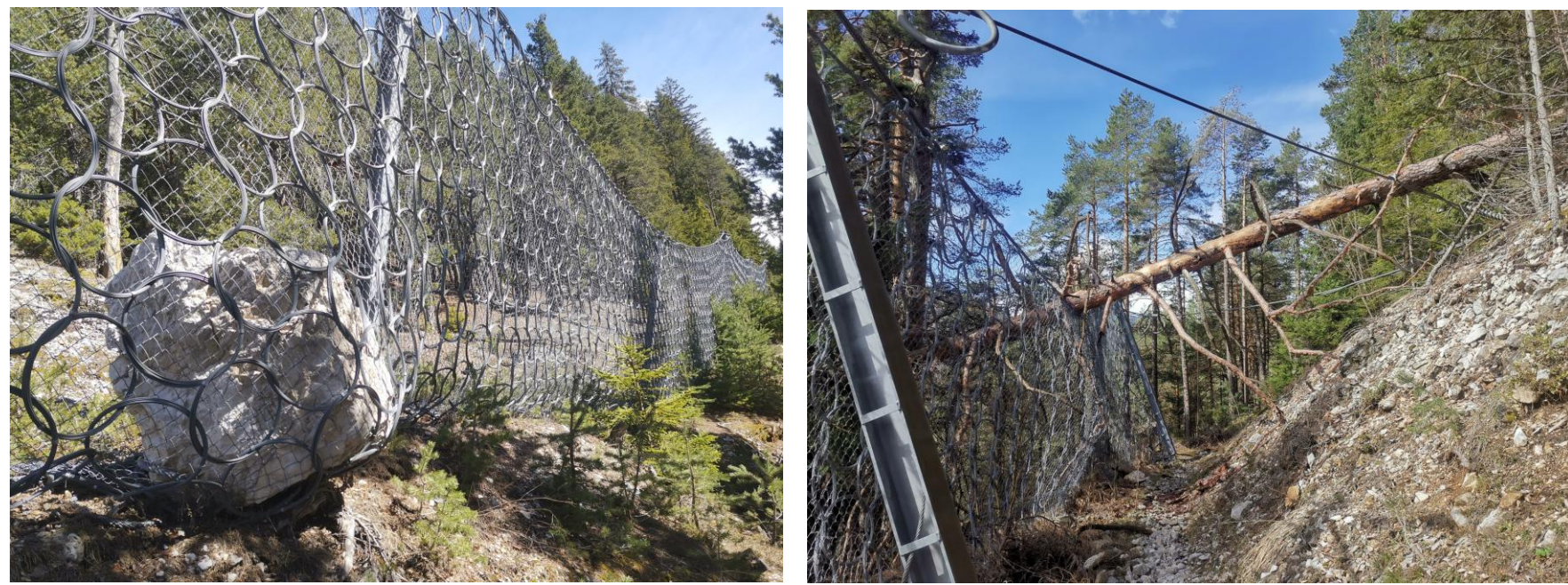
Abb. 1: Steinschlagblock und Baum im Steinschlagnetz (Quelle: S. Melzner 2024).
